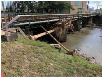
2022年10月04日撮影(清水区)鉄道の橋桁に流木が詰まり上流側沿岸が浸水
